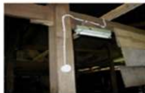
12V10W蛍光灯3灯
