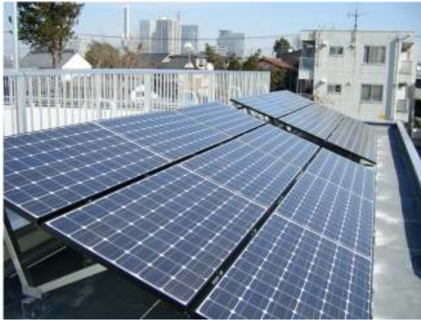
屋上のパネル (3.6kW)
