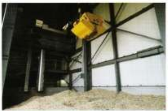
チップヤード&クレーン
