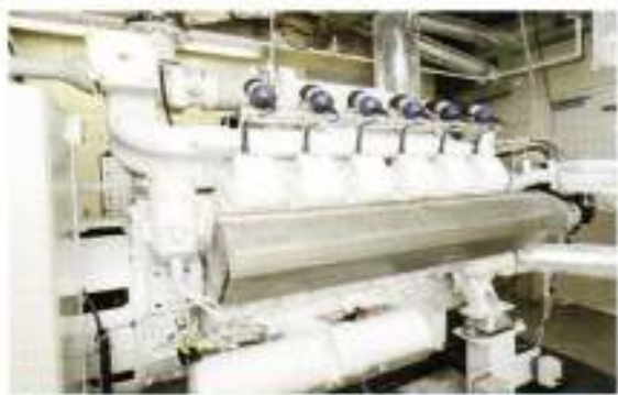
ガスエンジン
